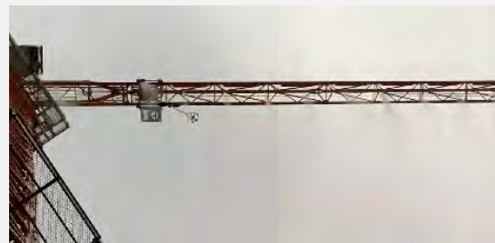
塔吊喷淋系统
