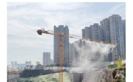
项目喷淋系统
