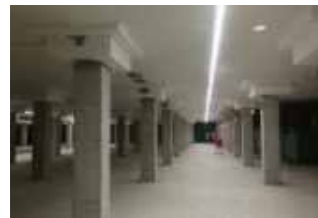
工地LED灯带照明
