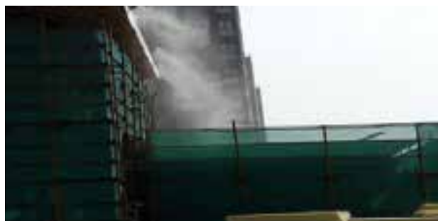
外架喷淋系统
