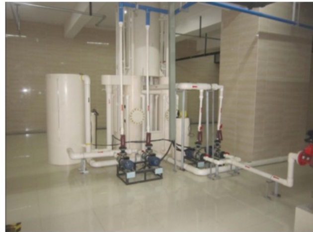
成都万象城水过滤设施
