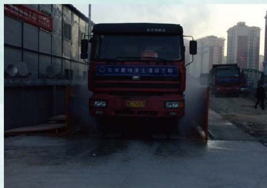
淄博凯旋门项目冲洗设施
