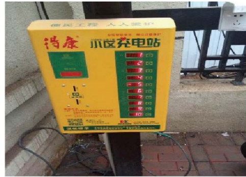
山东大区便民充电设备
