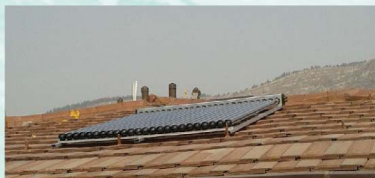
山东大区屋顶集中循环太阳能热水系统
